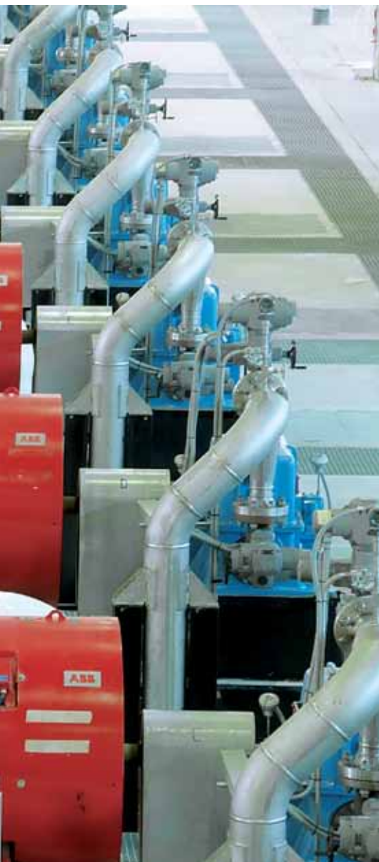
Torrevieja desalination plant, Alicante. Spain.
