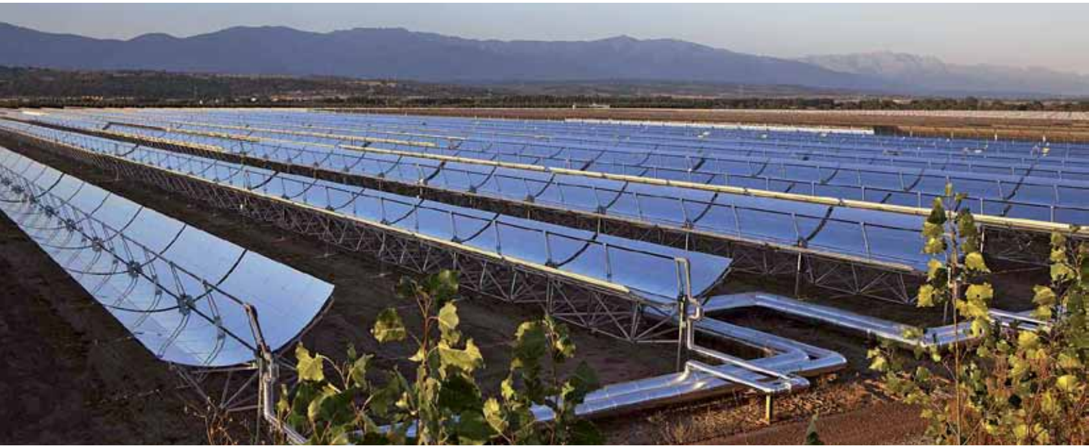
Solar thermal (CSP) plant. Majadas de Tiétar. Cáceres. Spain.
